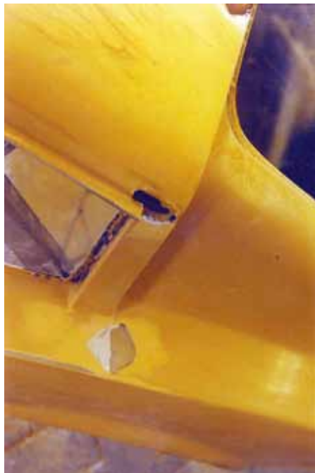
Hul og revner ved tagrenden skal fjernes og evt. forstærkes med stålband på bagsiden
