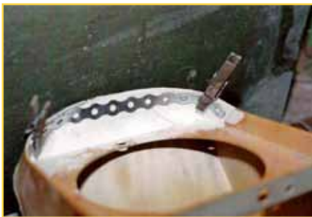
Forkanten af lygtehuset forstærkes med et stålband, der støbes fast med epoxylim
