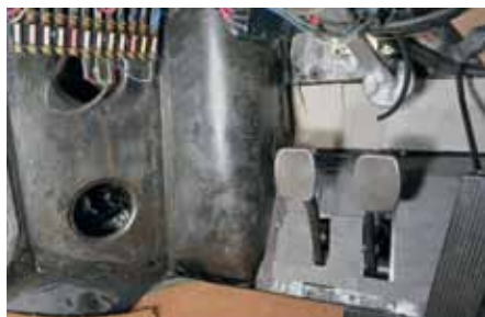
Extra dräneringshål till hållrummet + spru-tad rostskyddsolja!
